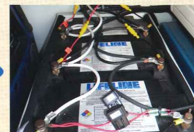
ソーラーパネルより蓄電
